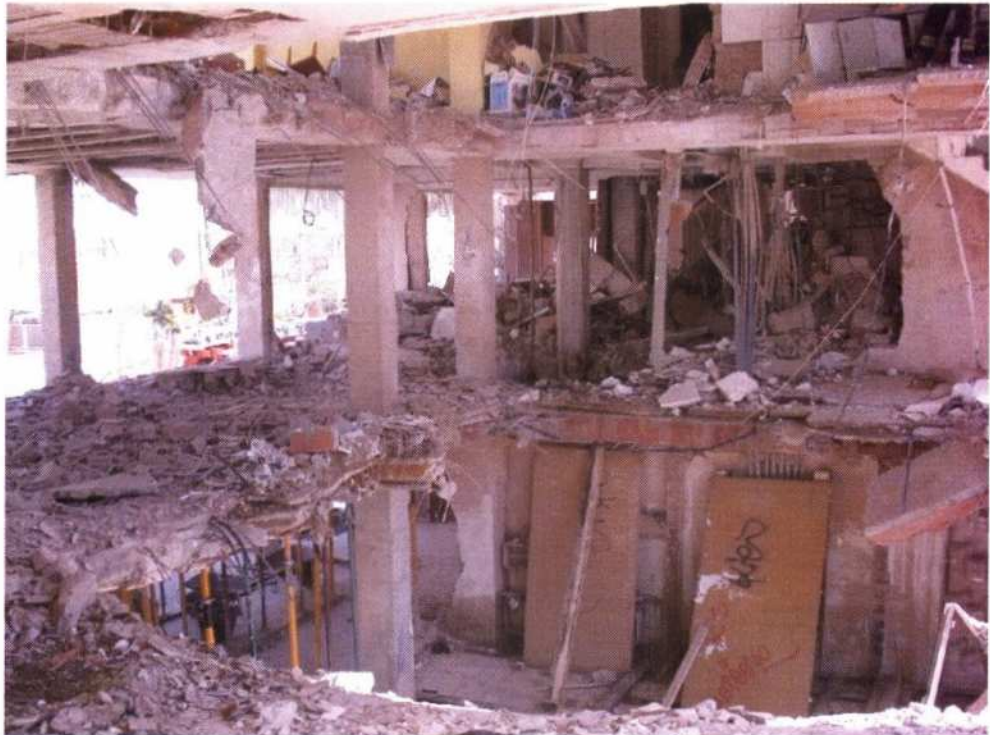
VISTAS DEL DERRUMBE EN EL INTERIOR DEL EDIFICIO
