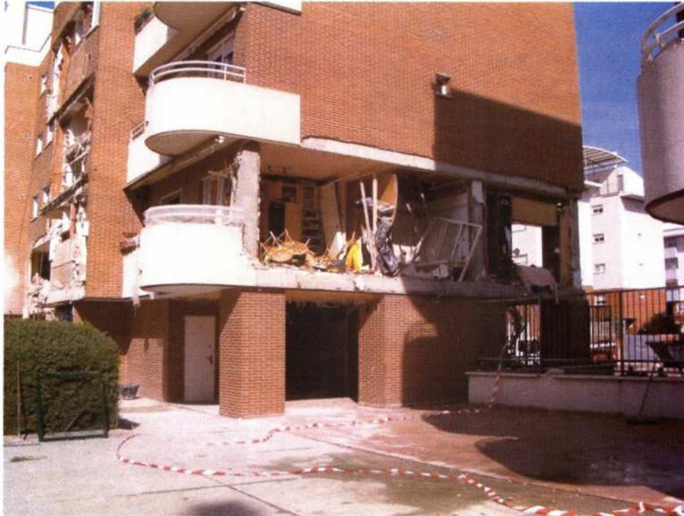
VISTA DE LOS EFECTOS DE LA EXPLOSIÓN EN LA FACHADA LATERAL
