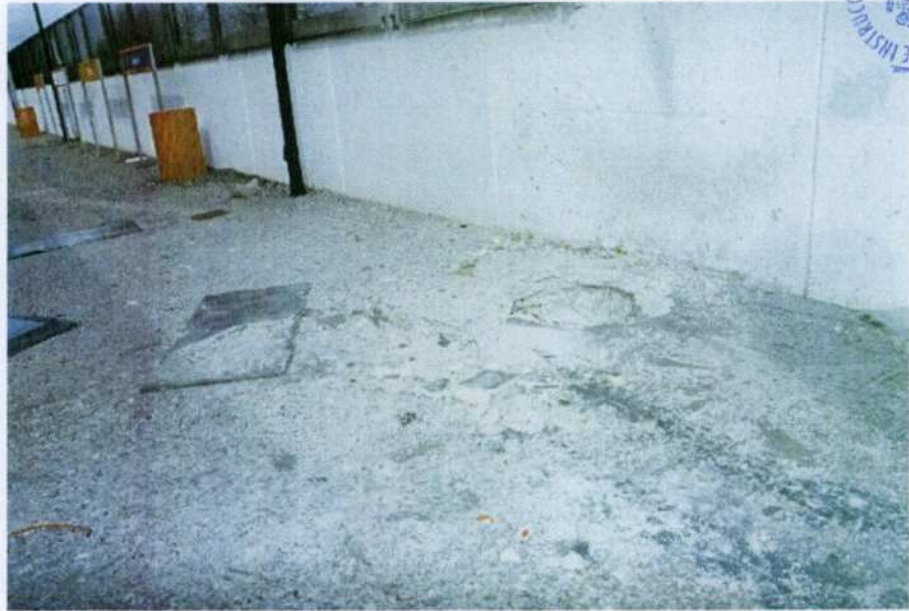
VISTAS DE LOS EFECTOS DE LA METRALLA EN EL MURO DEL ANDÉN
