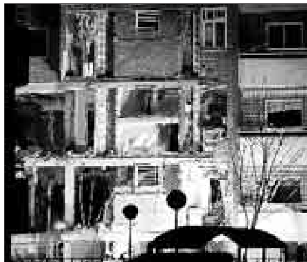
El edificio, tras la explosión de los 20 kilos de Goma 2. / DIEGO SINOVA
