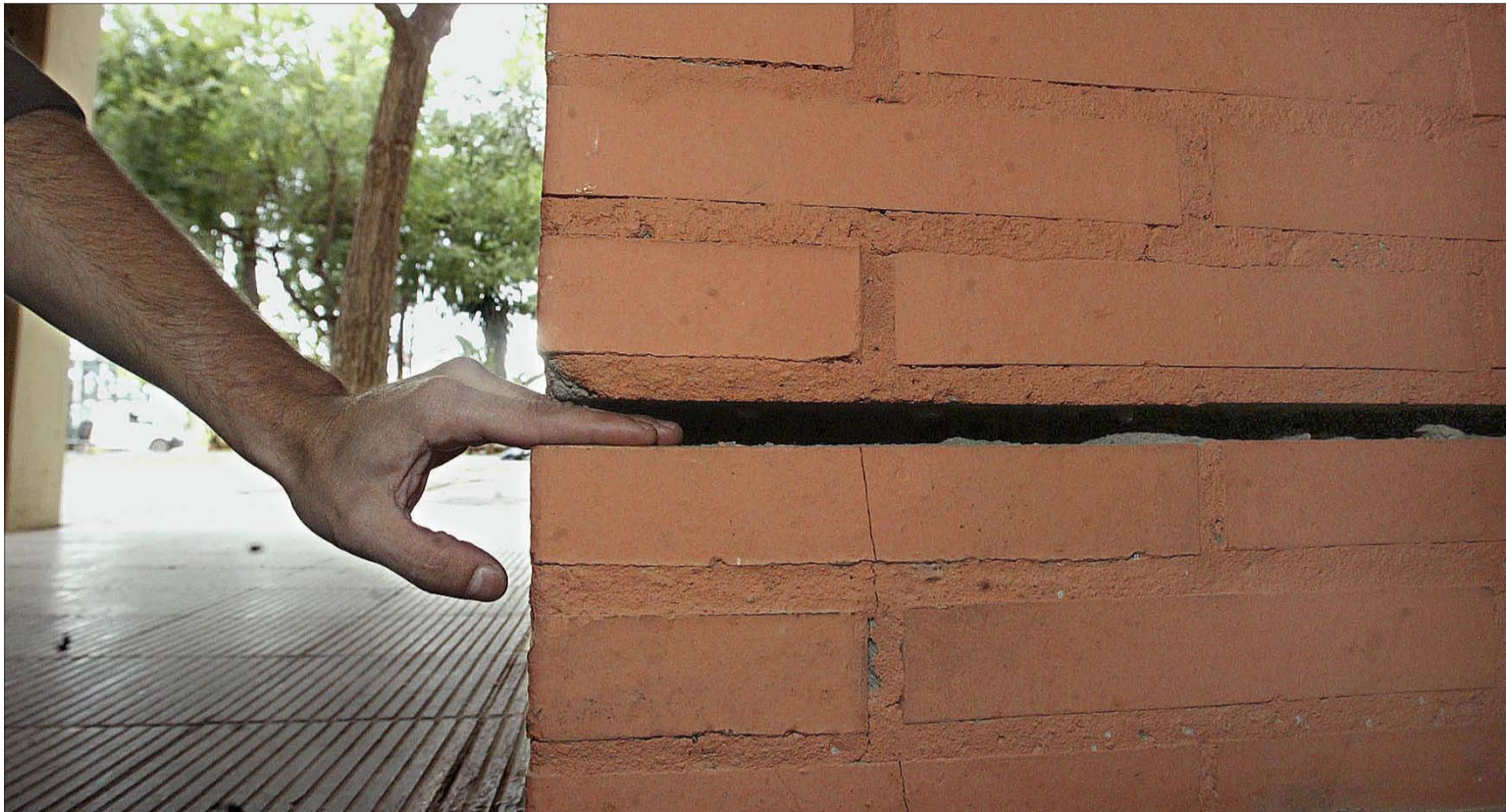
Un vecino muestra la grieta provocada por las obras del AVE en la estructura de un bloque de pisos, ayer, en Hospitalet de Llobregat (Barcelona). / ANTONIO MORENO
